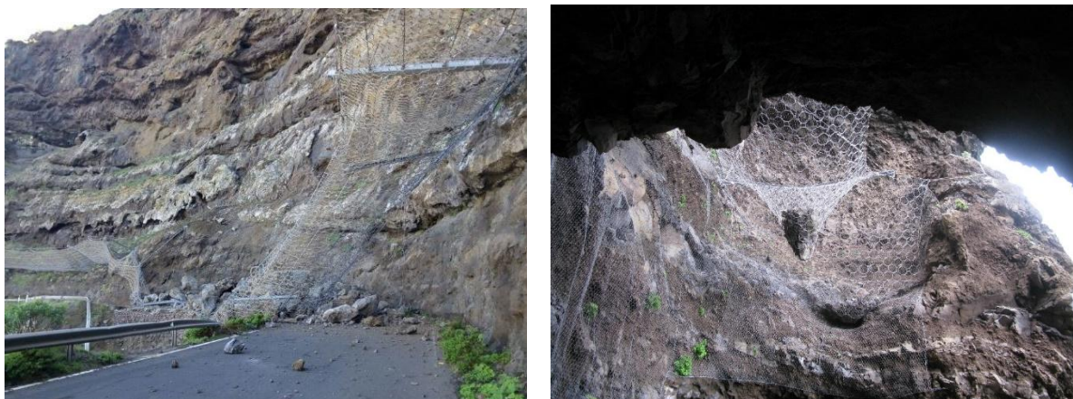
Figura 6. Impacto y fallo en barrera instalada en pasarela, GC-200 (izda.). Impacto y mantenimiento de gálibo mínimo en barrera instalada en pasarela, TF-445 (dcha.).
