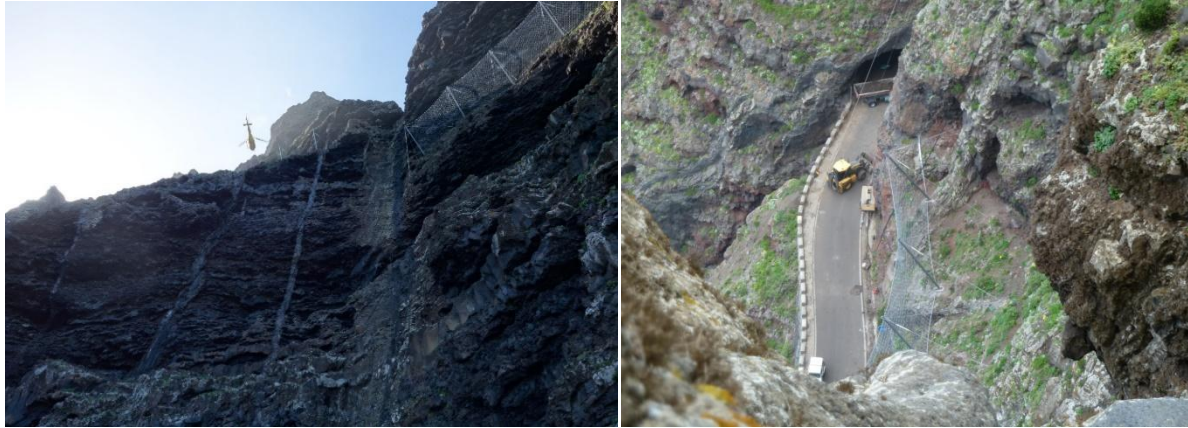
Figura 5. Instalación de barreras mediante helicóptero (izda.). Ubicación de una de las barreras de retención de flujos y panorámica de barreras alineadas bajo ella (dcha.).
